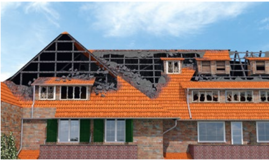
Abb. 23 Gebäude nach einem Dachstuhlbrand
