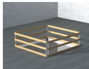
Abb. 5 Sicherung einer Öffnung durch Seitenschutz
