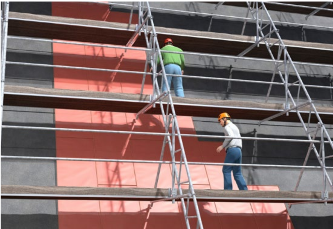
Abb. 123 Arbeitsgerüst an steiler Dachfläche
