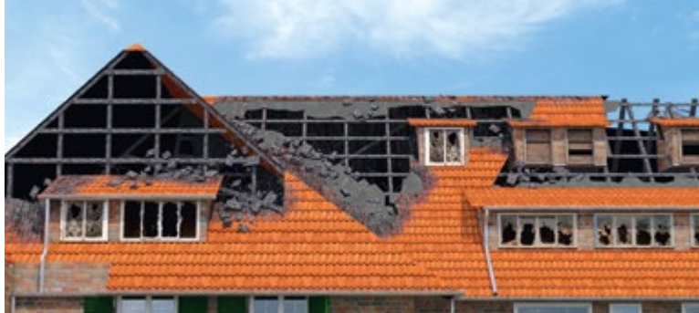
Abb. 20 Gebäude nach einem Dachstuhlbrand
