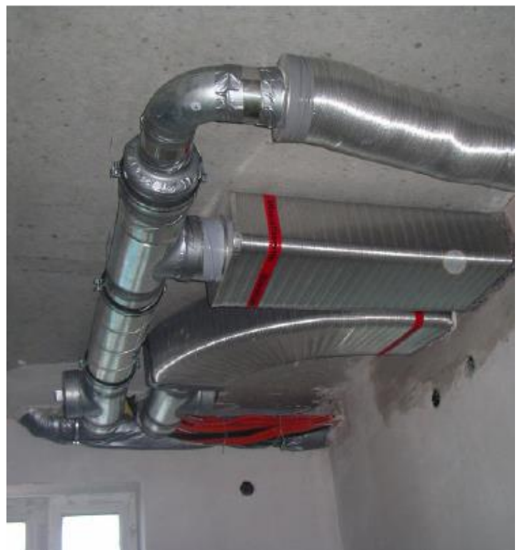
Abbildung 67: Zentrales Zu-/ Abluftsystem mit Wärmerückgewinnung mit Schalldämpfern
