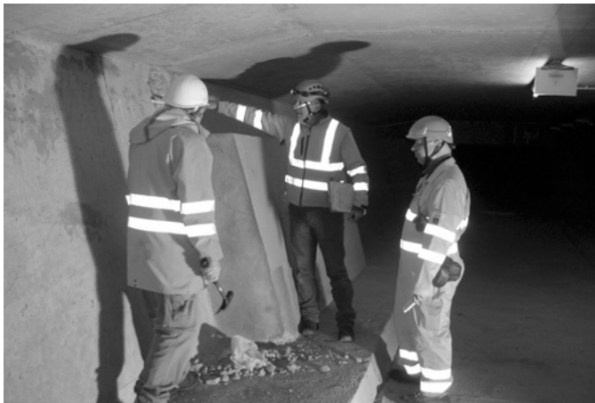
Monitoring der vorhandenen Bauwerksrisse
